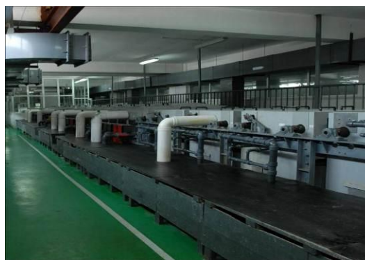
污水处理装置
